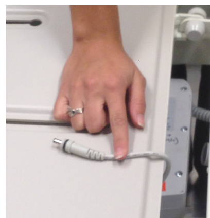
Figur 5 – Frakobling af batterikablet fra kontrolboksen
