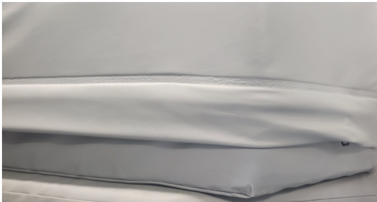
Figur 2 – Skyddsbarriär för vattenavrinning
